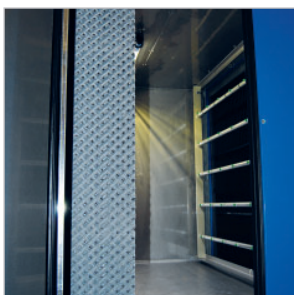
Installation d'un nouvel humidificateur hybride efficace
